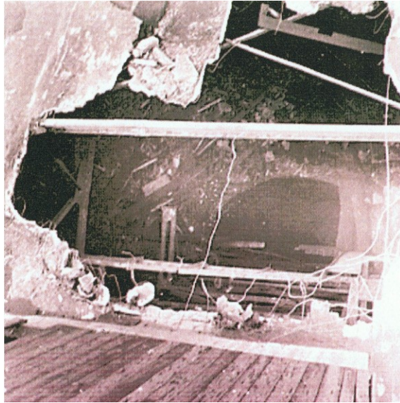
Abbildung 28: Ausmaß der Schäden unter Tage am 07.07.1953 [106]
